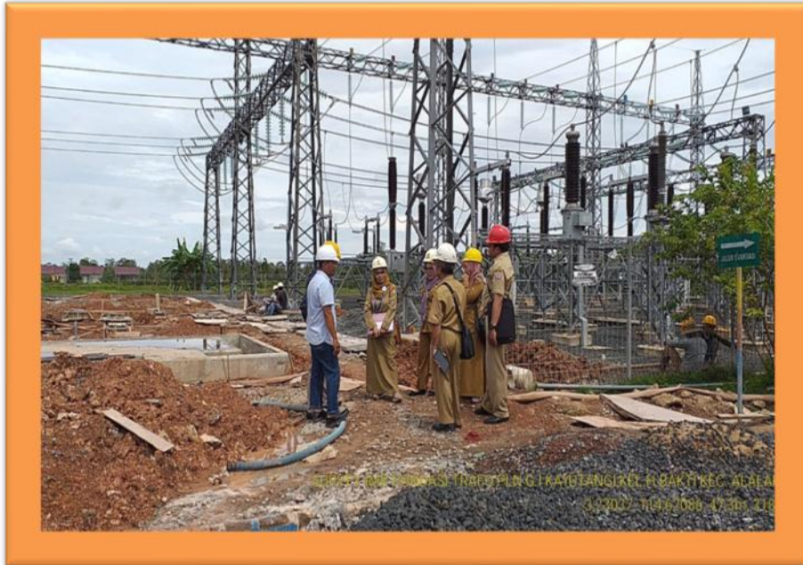
KET : SURVEY IZIN MENDIRIKAN BANGUNAN ( IMB ) GI 150 KV Kayutangi Extension Trafo Bay untuk 60 MVA PT. PLN (Persero) Unit Induk Pemb. Kalimantan Bag. Tengah, Unit Pelaksana Proyek Pembangkit & Jaringan Kalimantan Bagian Tengah 1, an. NANANG ZUAIDI
